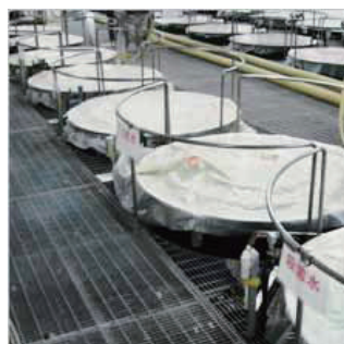
弱酸性次亜水貯蔵用タンク
